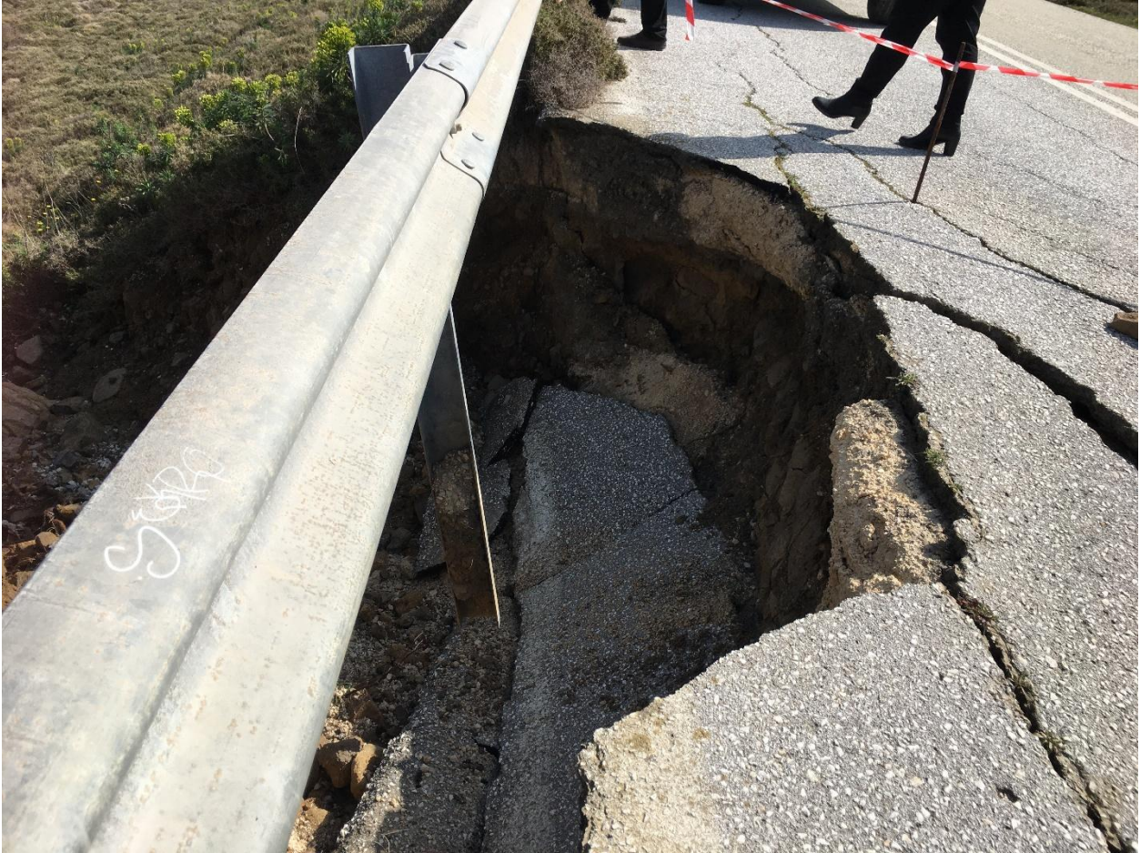
Φωτογραφία 1, 2: Υποχώρηση δρόμου και τοιχίου αντιστήριξης μήκους 22,00μ.
