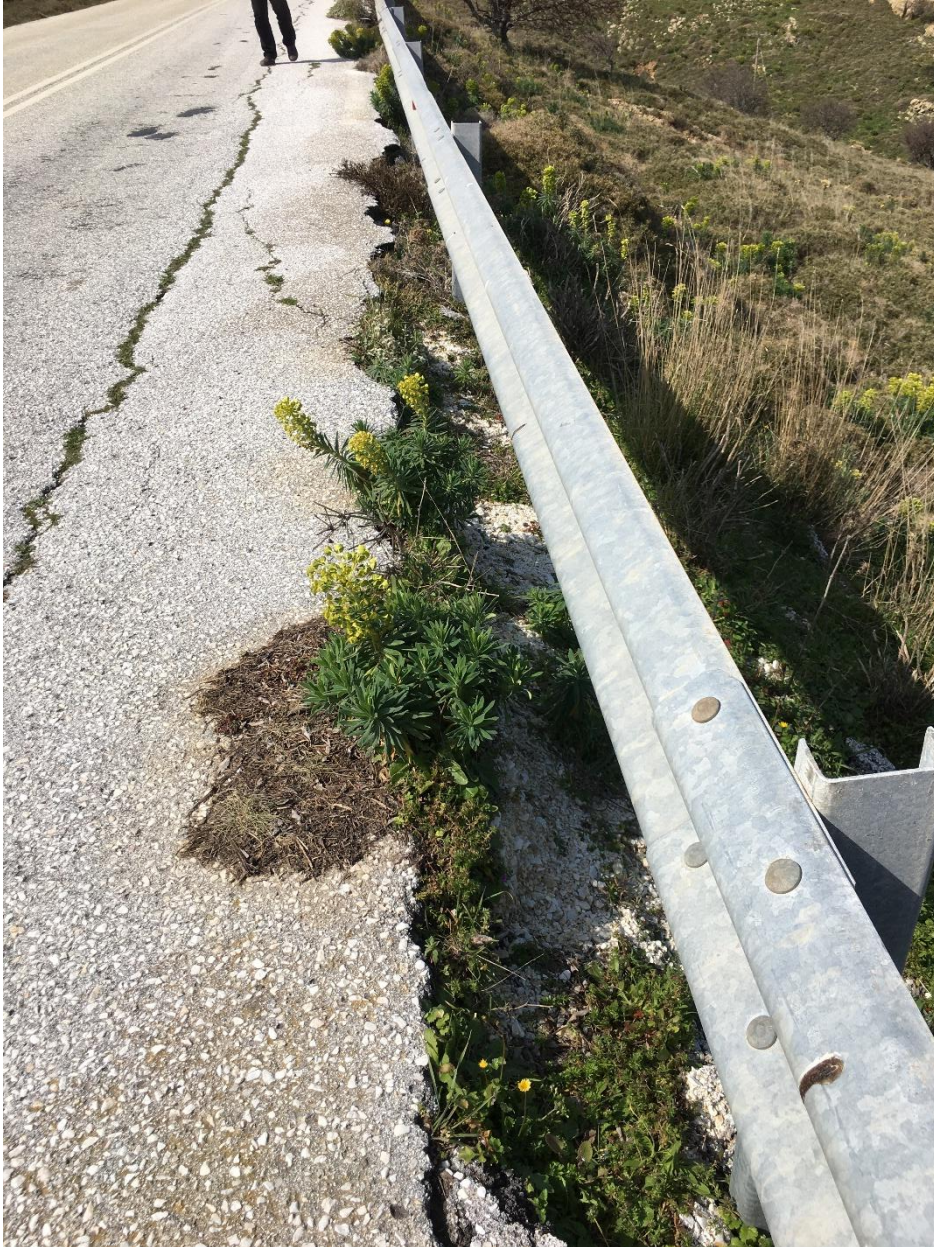
Φωτογραφία 3, 4 : Υποσκαφή δρόμου σε μήκος 47,00μ.
