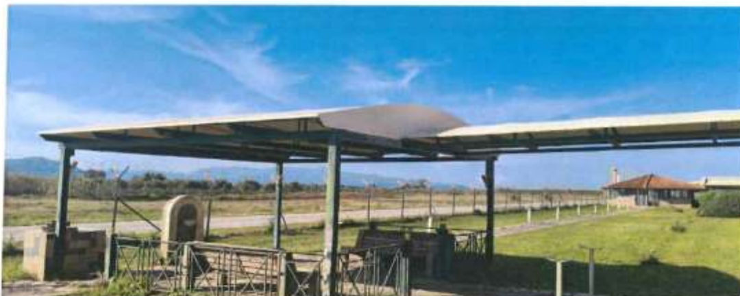
Εικόνα 1. Υφιστάμενη κατάσταση στεγασμένης μεταλλικής κατασκευής.
